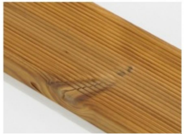
Единичная трещина от сучка допускается
